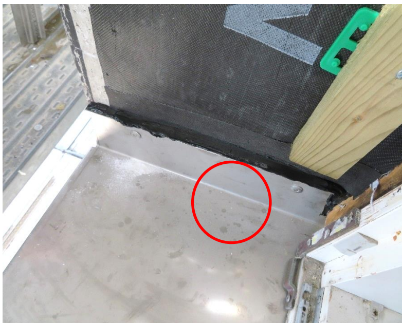
Foto 8.1: Fugning stående false. Udsåret hak i bundlysning.
