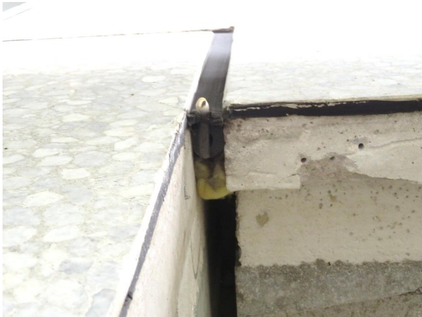
Foto 1: Eksisterende fugebånd og elastiske fuger.
